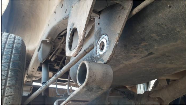
Imagen Num.11 de bujes dañados
